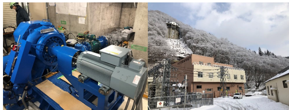
鎧畑発電所3号機 新型水車
