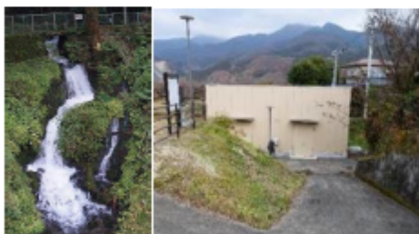
湧水の水源(左)、住宅地に配慮した発電所建屋(右)
