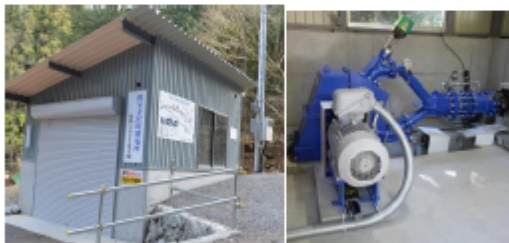
発電所建屋とスロベニア製の水車
