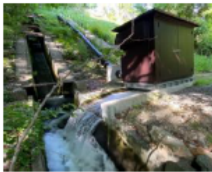
発電機・建屋一体型の小水力発電システム
