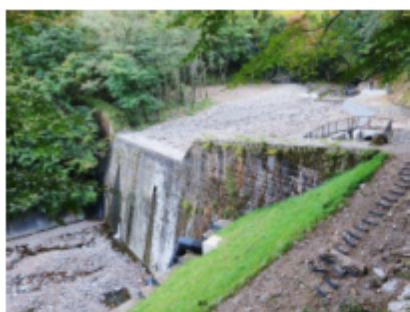
県の砂防堰堤を取水に利用
